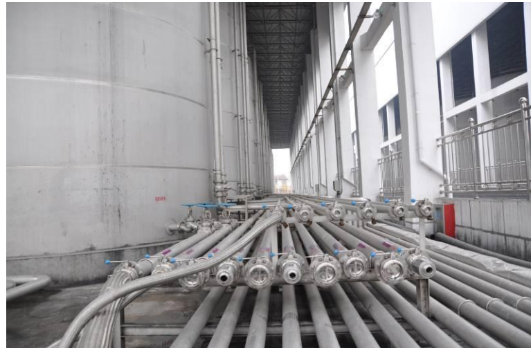
不锈钢储存酒灌区、输送管道、不锈钢软管
